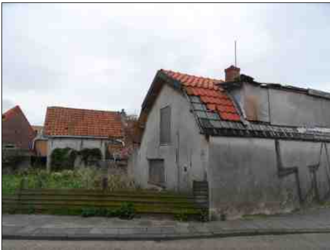
Afbeelding 2. Woningen gezien vanaf de straat. De vervallen staat is evident.
