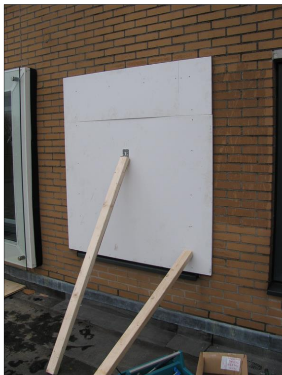
Foto II.4 Provisorische afdichting tweede raam
