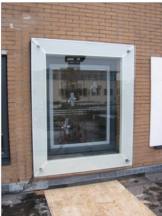
Foto II.3 Aanzicht glazen gevelgeluidscherm
