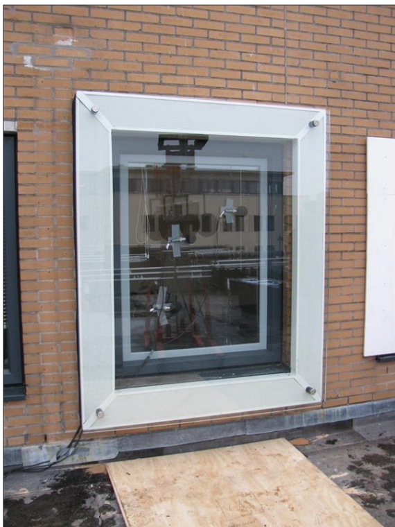
Foto II.3 Aanzicht glazen gevelgeluidscherm
