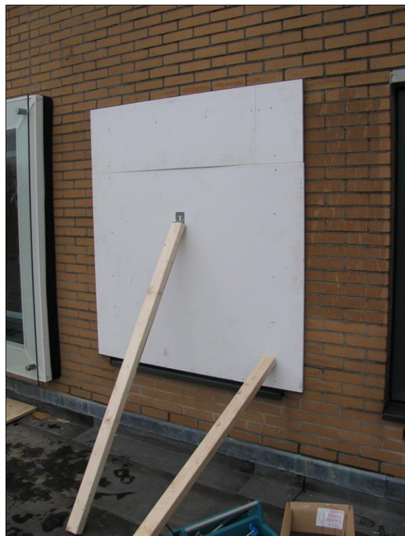
Foto II.4 Provisorische afdichting tweede raam
