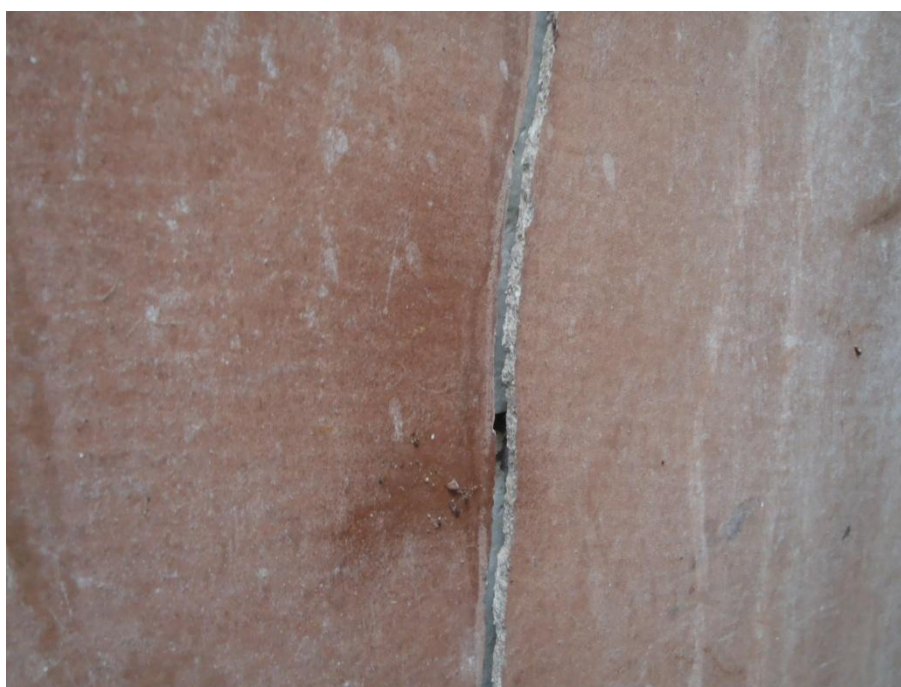
Foto 4: Asbestverdachte beplating koelcel
