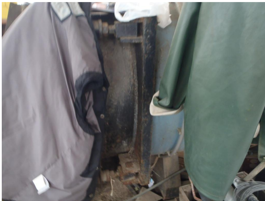
Foto 3: Asbest verdacht koord
