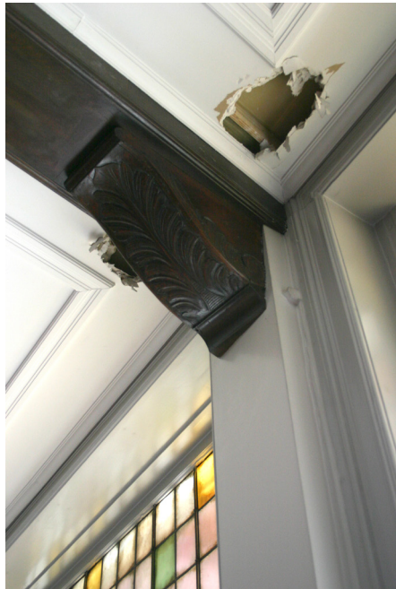
Afb. 20 Eén van de historiserend vormgegeven consoles. Door het gat rechts is zichtbaar dat een ouder plafond schuilgaat achter het huidige plafond.
