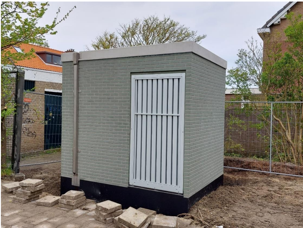
afbeelding 2: nieuw geplaatste technische ruimte van KPN ten noorden van het plangebied
