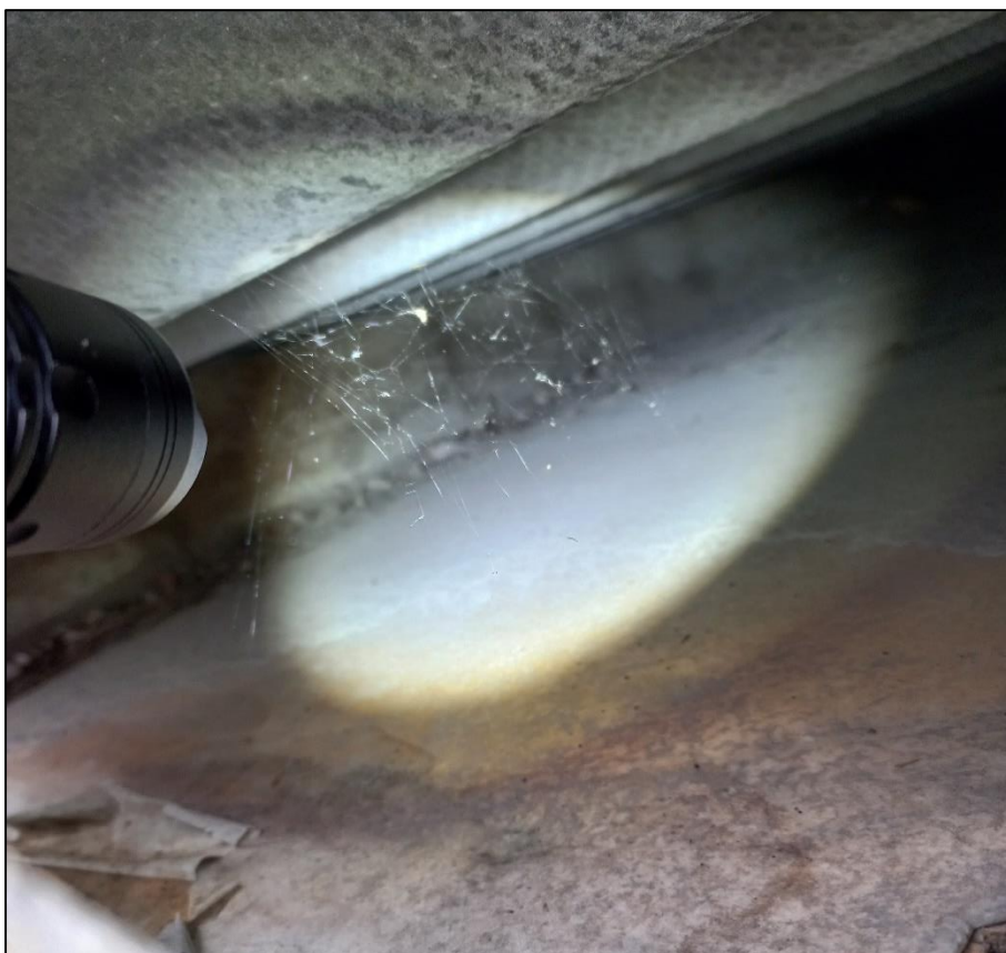
Figuur 4: Onder de dakplaten is tussen de draagbalken een grote open ruimte aanwezig van 1x0.2x30m.
