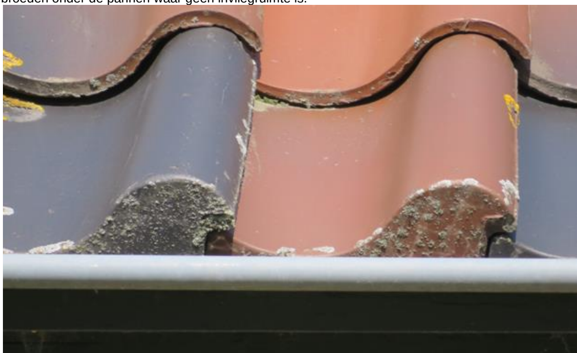
Geen ruimte voor mussen om te broeden tussen onderste rij pannen en dakgoot.
