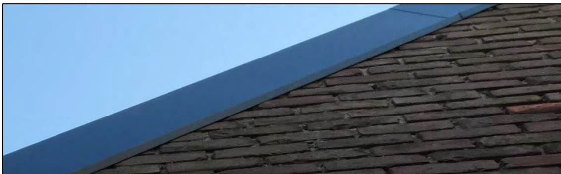
Figuur 12: Afwerking daklijsten, deze zitten strak tegen de muur. Beschermde soorten worden hier niet verwacht.
