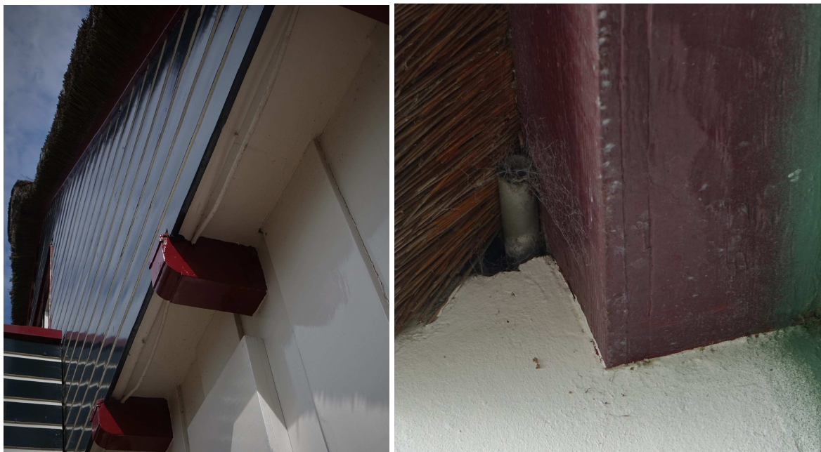
Figuur 6. Houten betimmering aan de gevel biedt geen invliegmogelijkheden voor vleermuizen (links) en mogelijke openingen bevatten oud vuil en spinrag (rechts) en worden niet gebruikt als verblijfplaats door vleermuizen.
