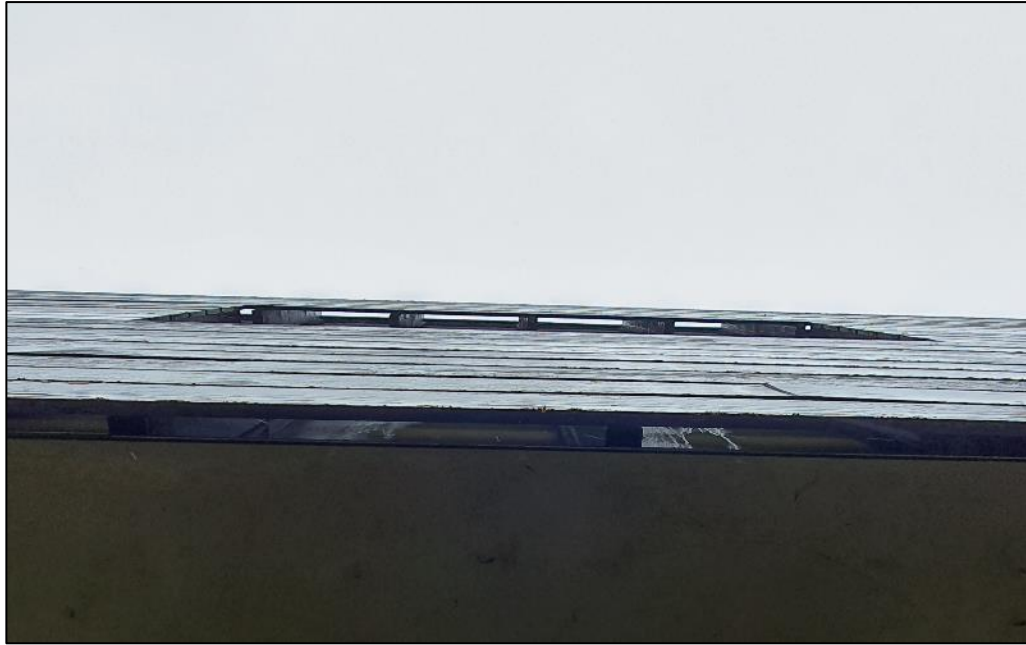
Figuur 4 Fotografische onderbouwing van de zwevende gevelbekleding met zichtbaar regeninslag en te veel ruimte om geschikt te zijn als vleermuisverblijfplaats.
