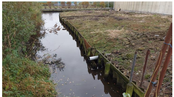
Foto 06 - asbestverdachte beschoeiing MV102 [A03]
