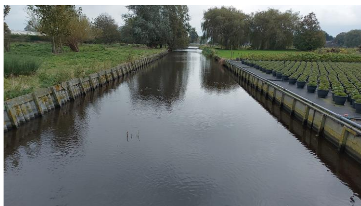
Foto 10 - asbestverdachte beschoeiing MV103 [A04]
