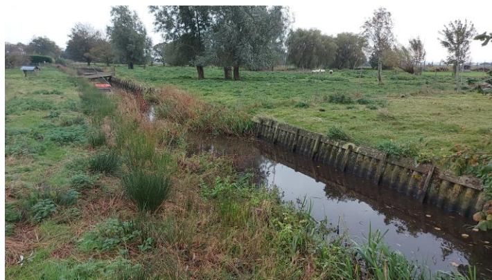
Foto 08 - asbestverdachte beschoeiing MV103 [A04]
