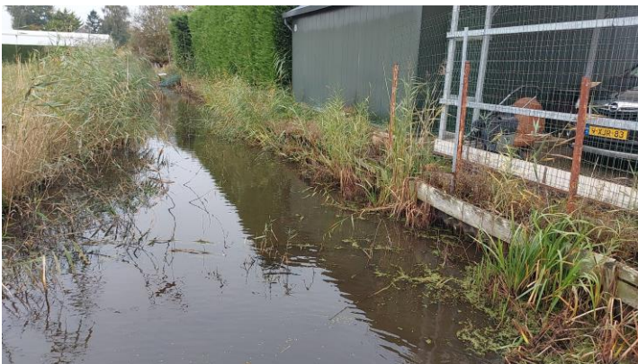
Foto 05 - asbestverdachte beschoeiing MV102 [A02]
