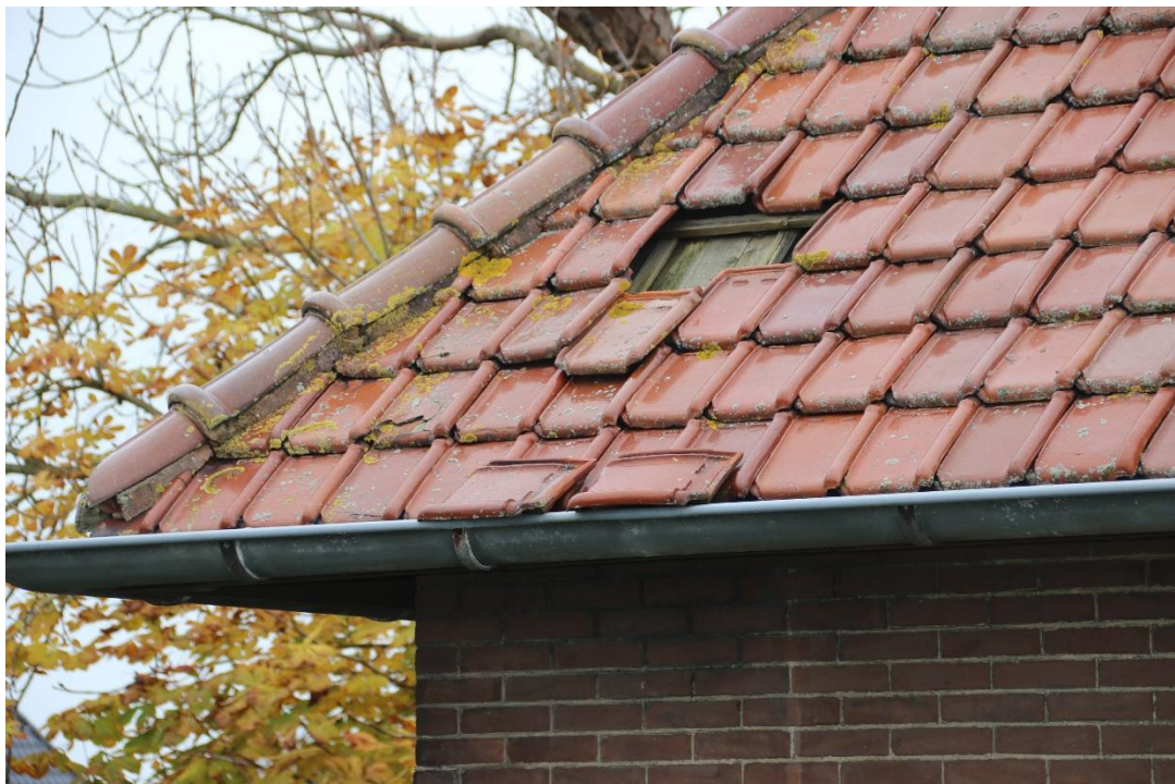
Invliegopening voor Gierzwaluw (en vleermuizen)
