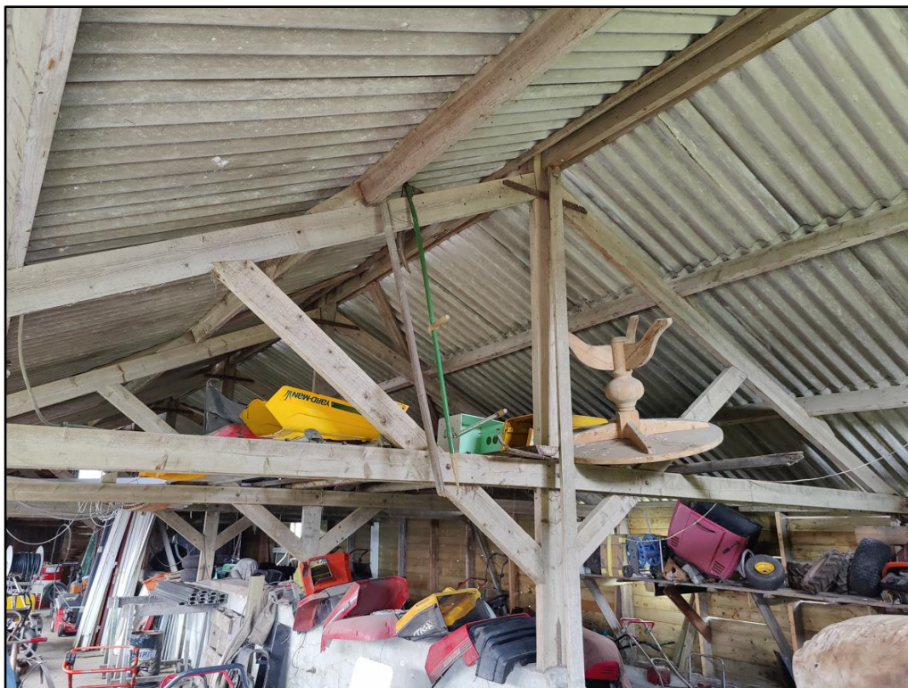
Figuur 2 De te slopen stal '4' beschikt niet over dakbeschot waardoor er geen nestlocaties voor de huismus aanwezig zijn.
