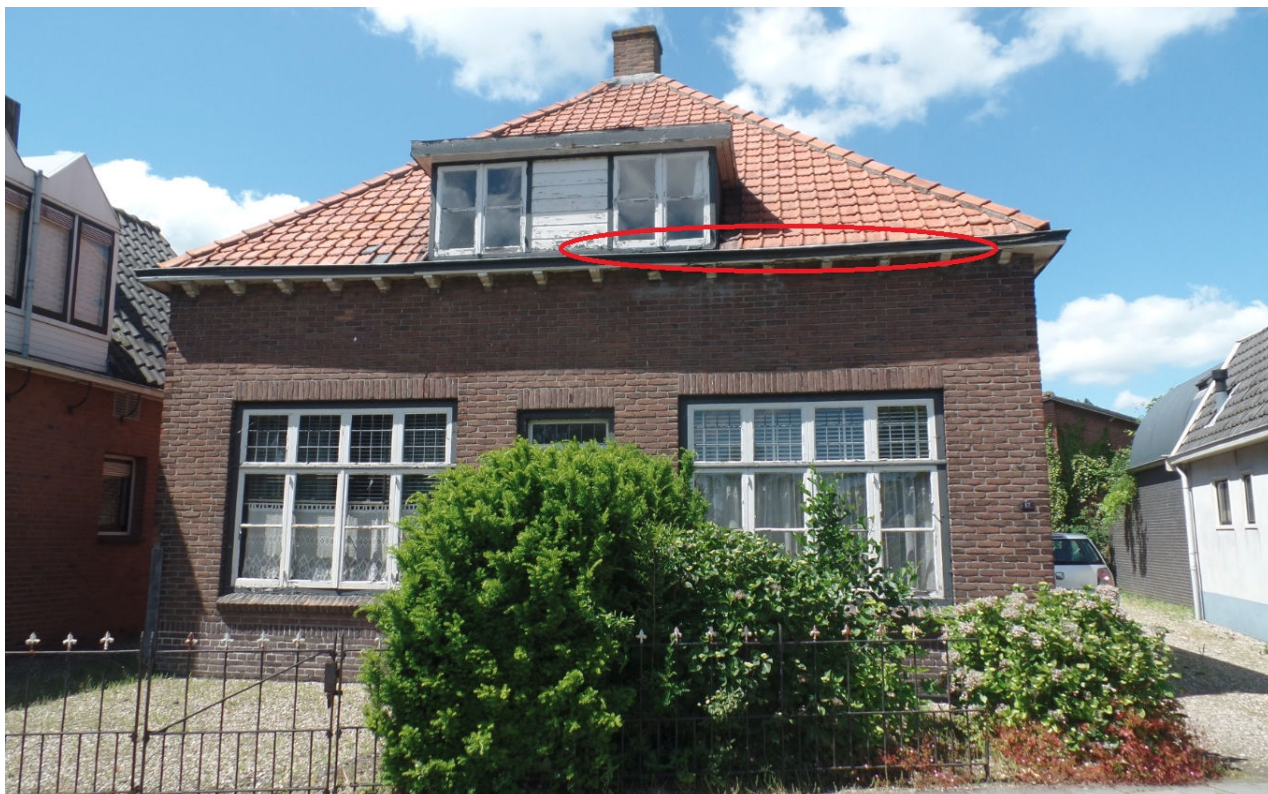
Figuur 5: Locatie in de dakgoot waar meerdere Huismussen zijn waargenomen. Dit gedrag indiceert een mogelijke nestlocatie. Aan de binnenzijde van Dorpstraat 17 is in de slaapkamer op de eerste verdieping aan de voorzijde van het pand het geluid van jonge Huismussen waargenomen.
