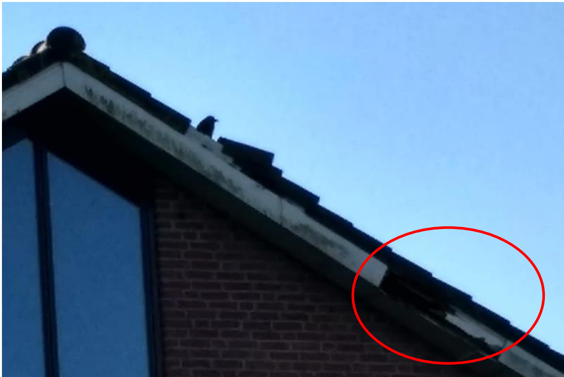
Afbeelding 5.9 Gat in de dakstructuur van het te slopen gebouw waarin een koppel kauwen zich heeft genesteld
