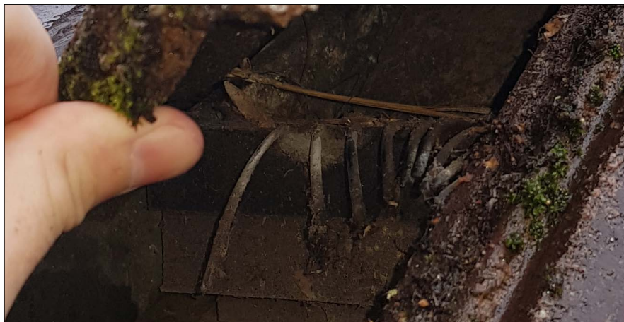
Figuur: onder de dakpannen is vogelschroot aangetroffen; de ruimte onder de dakpannen is daarom onbereikbaar voor de huismus of de spreeuw.
