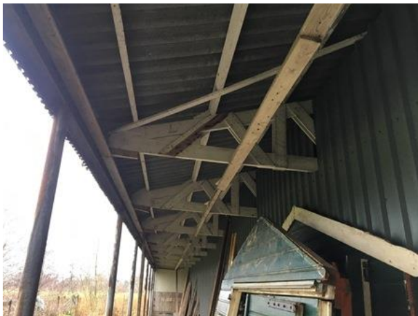
Mogelijk nestelen vogels in de dakspanten van de overkapping.
