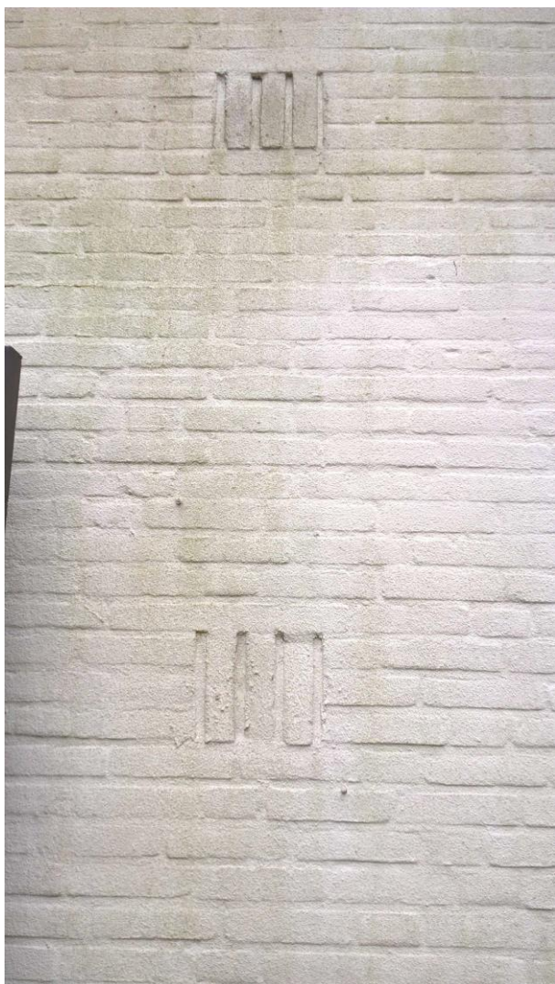
Figuur 10: Dichtgemaakte ventilatieroosters
