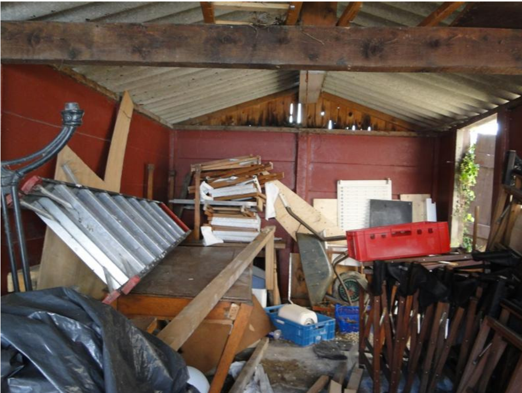
Figuur 8: Interieur schuur, gaten zichtbaar in de achterwand en onder het golfplaatdak.
