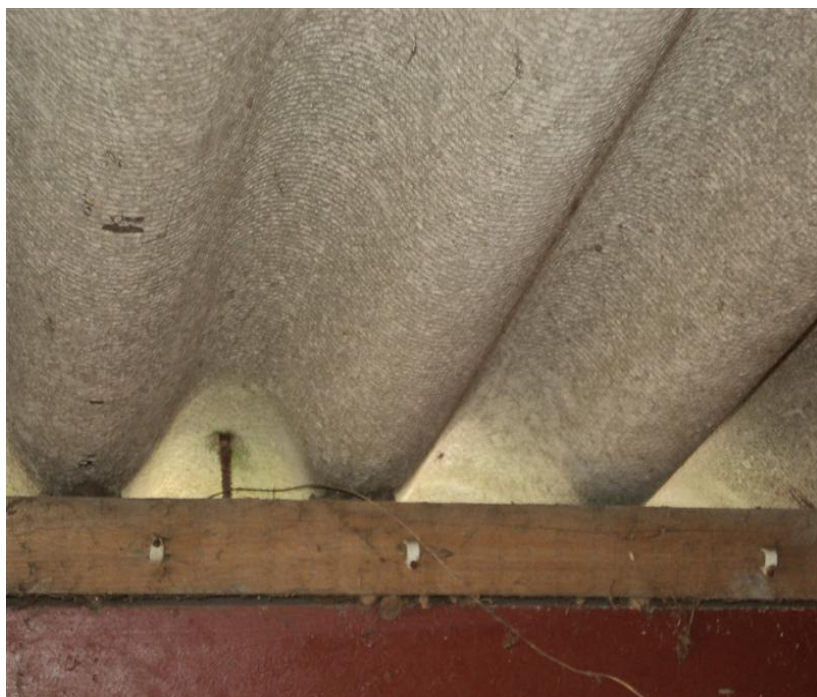
Figuur 7: Het golfplaatdak van het schuurtje.
