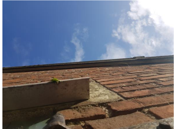
Figuur 4. Geen ruimte onder de dakrand van de stal aanwezig, er is een houten lat geplaatst tussen de dakrand en bakstenen muur.
