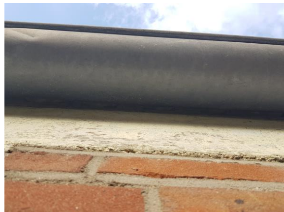
Figuur 6. Geen ruimte aanwezig onder de dakgoot.
