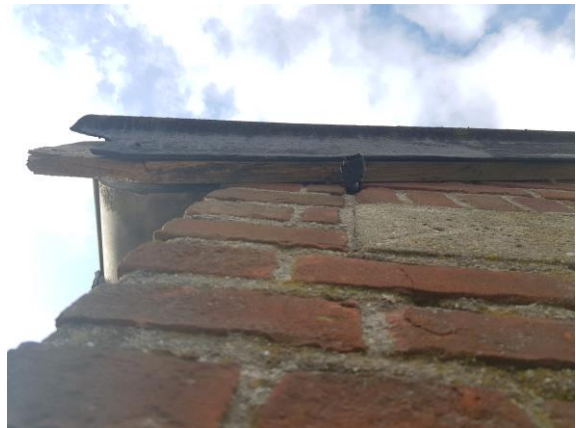
Figuur 8. Geen ruimte onder de dakrand van de stal aanwezig, er is een houten lat geplaatst tussen de dakrand en bakstenen muur.
