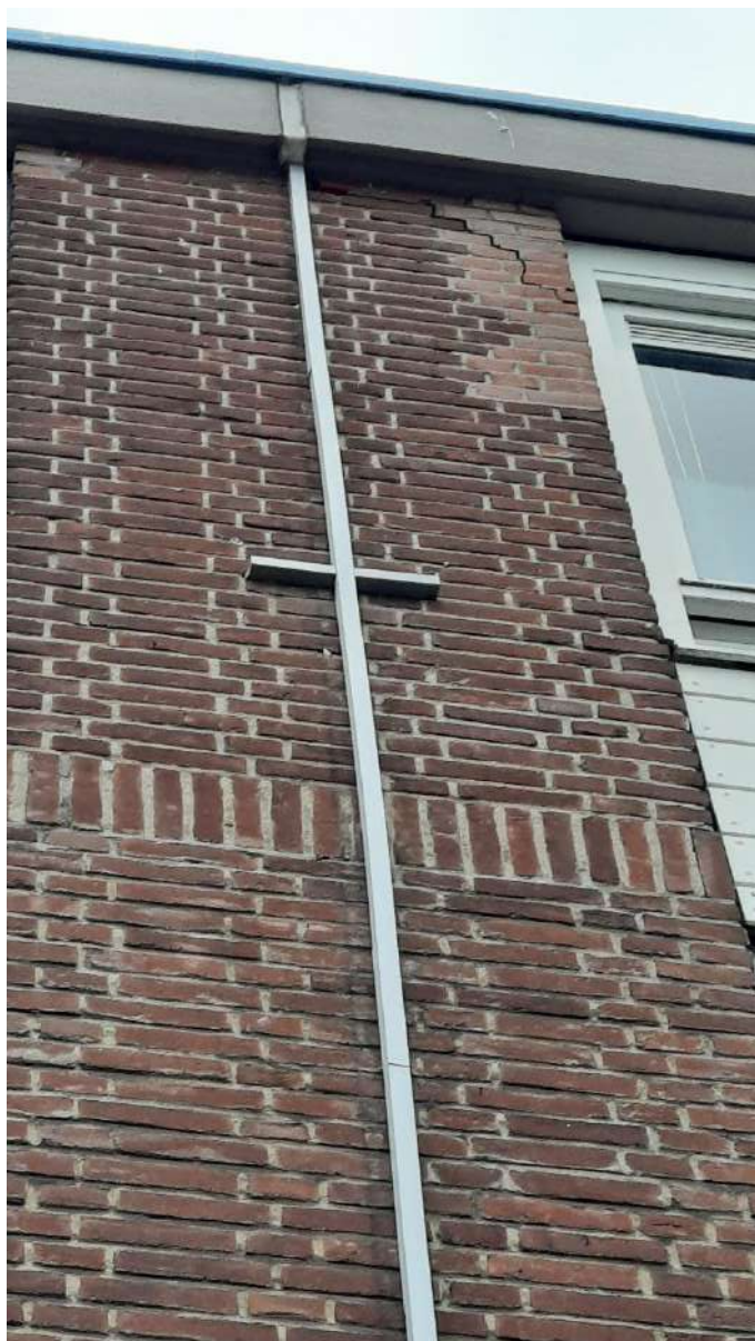
Figuur 9: Scheuren in metsel/voegwerk op de bovenste verdieping
