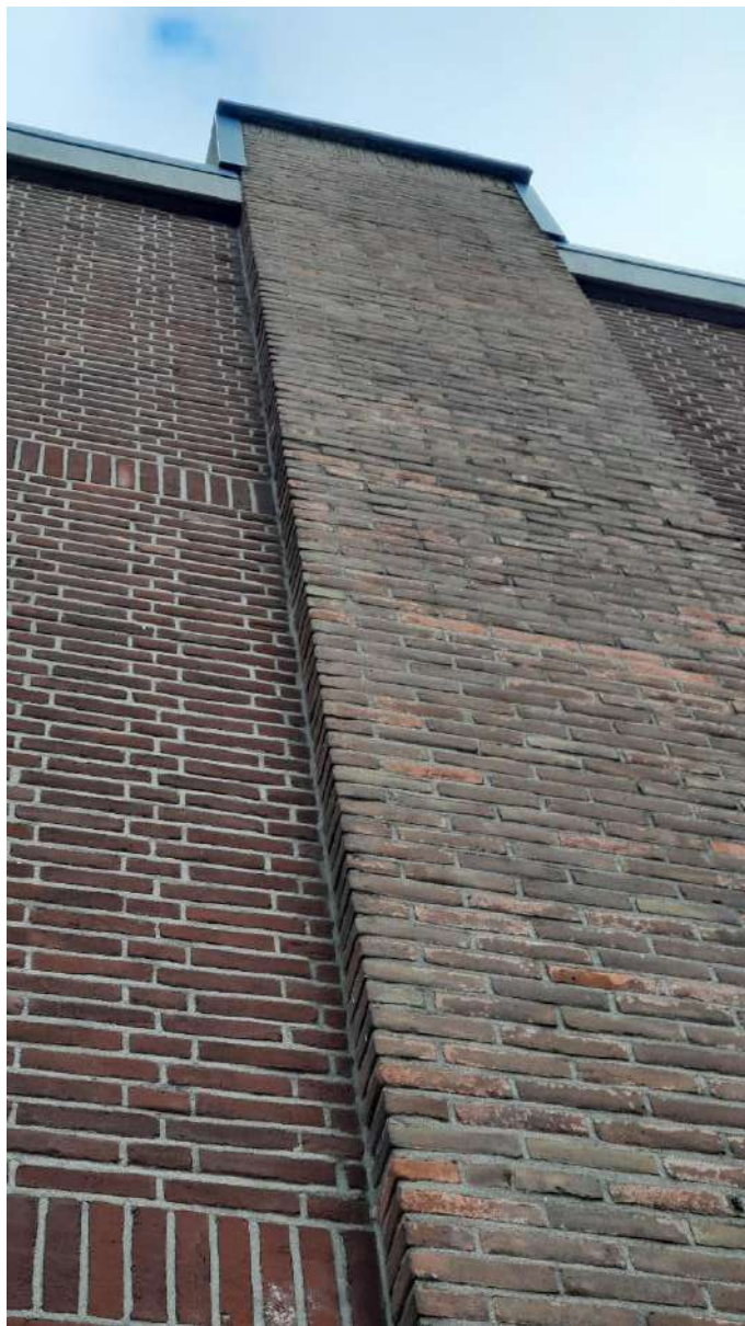
Figuur 7: Openingen in boeidelen langs de liftschacht
