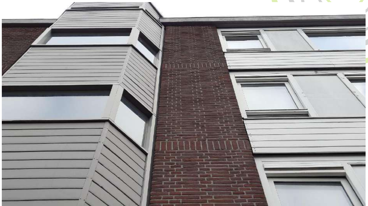
Figuur 8: Openingen van >1cm tussen de kunststof/houten kozijndelen en het metselwerk
