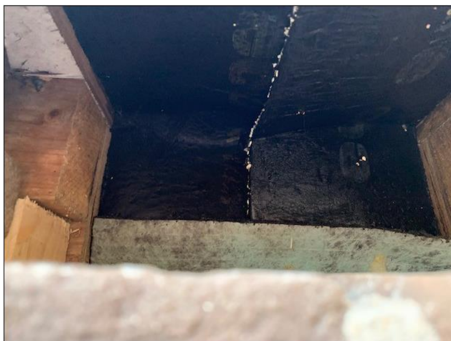
Figuur 4. Binnenkant van het gat in de gevel aan de noordoostzijde van het gebouw. Foto: Kubiek Ruimtelijke Plannen
