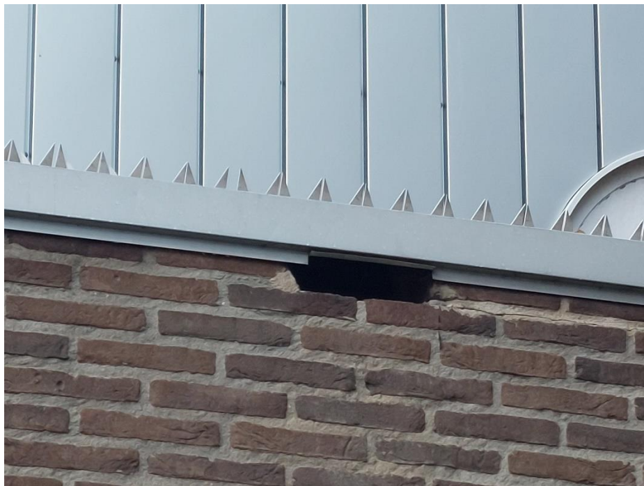
Figuur 3. Gat ter grootte van een baksteen aan de noordoostzijde van het gebouw. Foto G.S. Posthuma | Ecoresult B.V.
