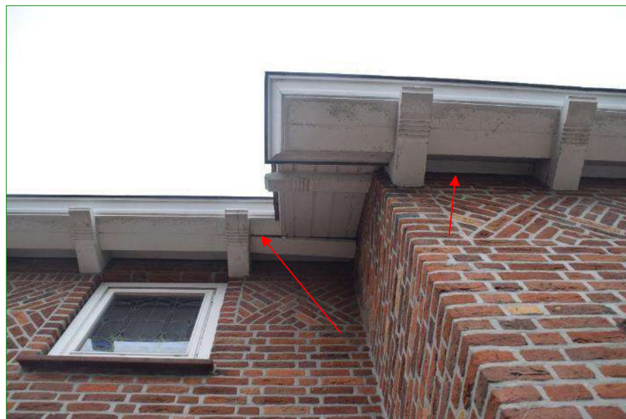
Kieren in dakrand van het woonhuis geven mogelijk toegang tot voor vleermuis geschikte achterliggende ruimtes.
