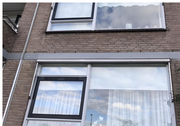
Figuur 11. Aan alle kanten van het appartementencomplex, en op elke verdieping zitten open stootvoegen boven de ramen.
