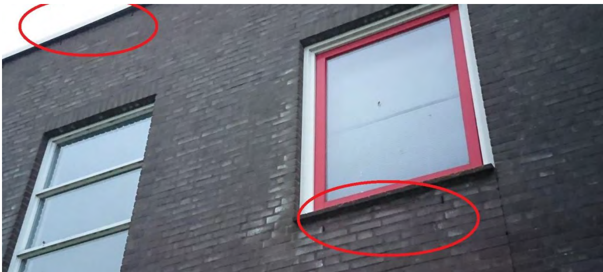
Figuur 5.1. Close up van de noordwestelijke muur van het schoolcomplex met met rood omcirkeld de openstootvoegen onder de ramen en onder de dakranden.
