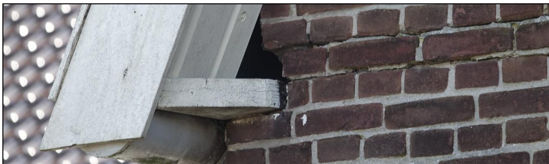
Figuur 13: Gootbekisting is niet overal sluitend afgewerkt waardoor openingen ontstaan.
