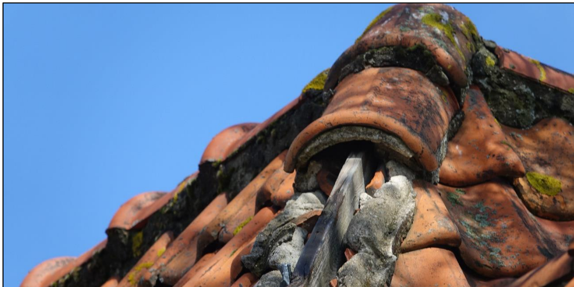
Figuur 8: Missende, gebroken of verschoven dakpannen zijn veelvuldig aanwezig en kunnen huismussen, gierzwaluwen, laatvliegers en dwergvleermuizen toegang tot een verblijfplaats verschaffen.
