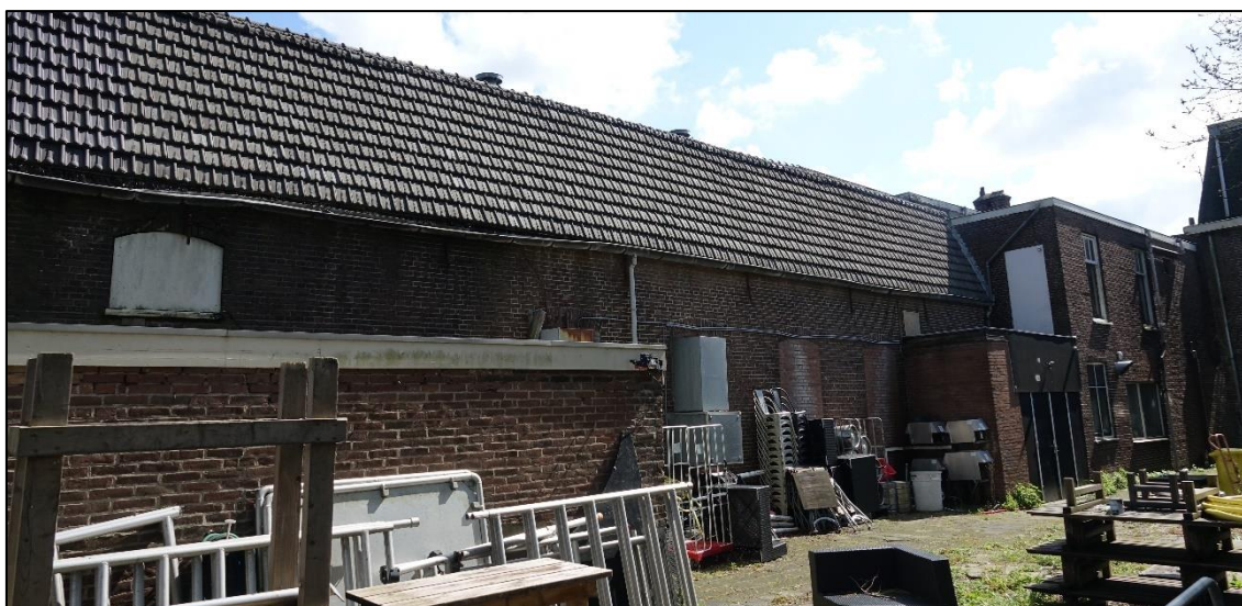
Figuur 4: De achterzijde van het pand aan Schoolstraat 11.
