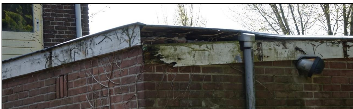
Figuur 11: Sommige van de houten boeiboorden van Schoolstraat 9 zijn sterk vergaan, waardoor toegang tot ruimte onder het dak verkregen kan worden. Tevens zijn ter hoogte van de onderste verdieping enkele ventilatieroosters zichtbaar.
