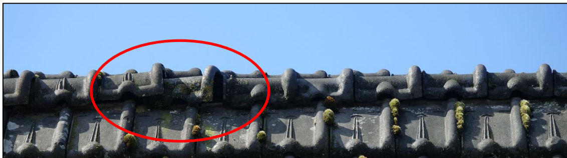
Figuur 12: Scheefliggende nokvorsten kunnen soorten toegang tot een verblijfplaats.
