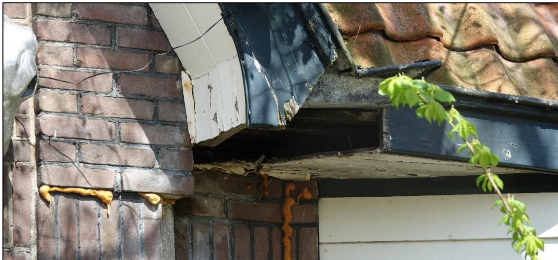
Figuur 9: In de gootbekisting van Schoolstraat 5 zijn grote gaten en missende delen aanwezig, hetgeen door o.a. broedvogels gebruikt kan worden als nestplaats.
