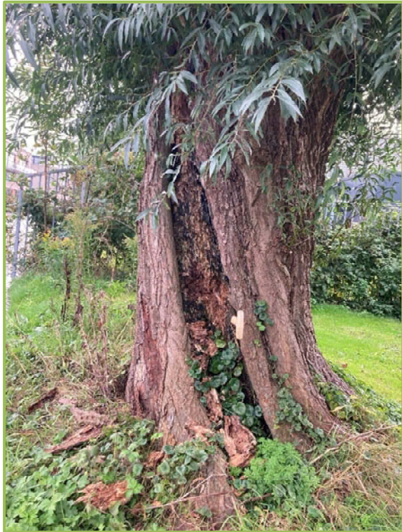
De oude knotwilg (nr. 33) heeft een omvangrijke stamrotting. Gezien de boomgrootte en standplaats vormt deze boom geen gevaar voor de omgeving.
