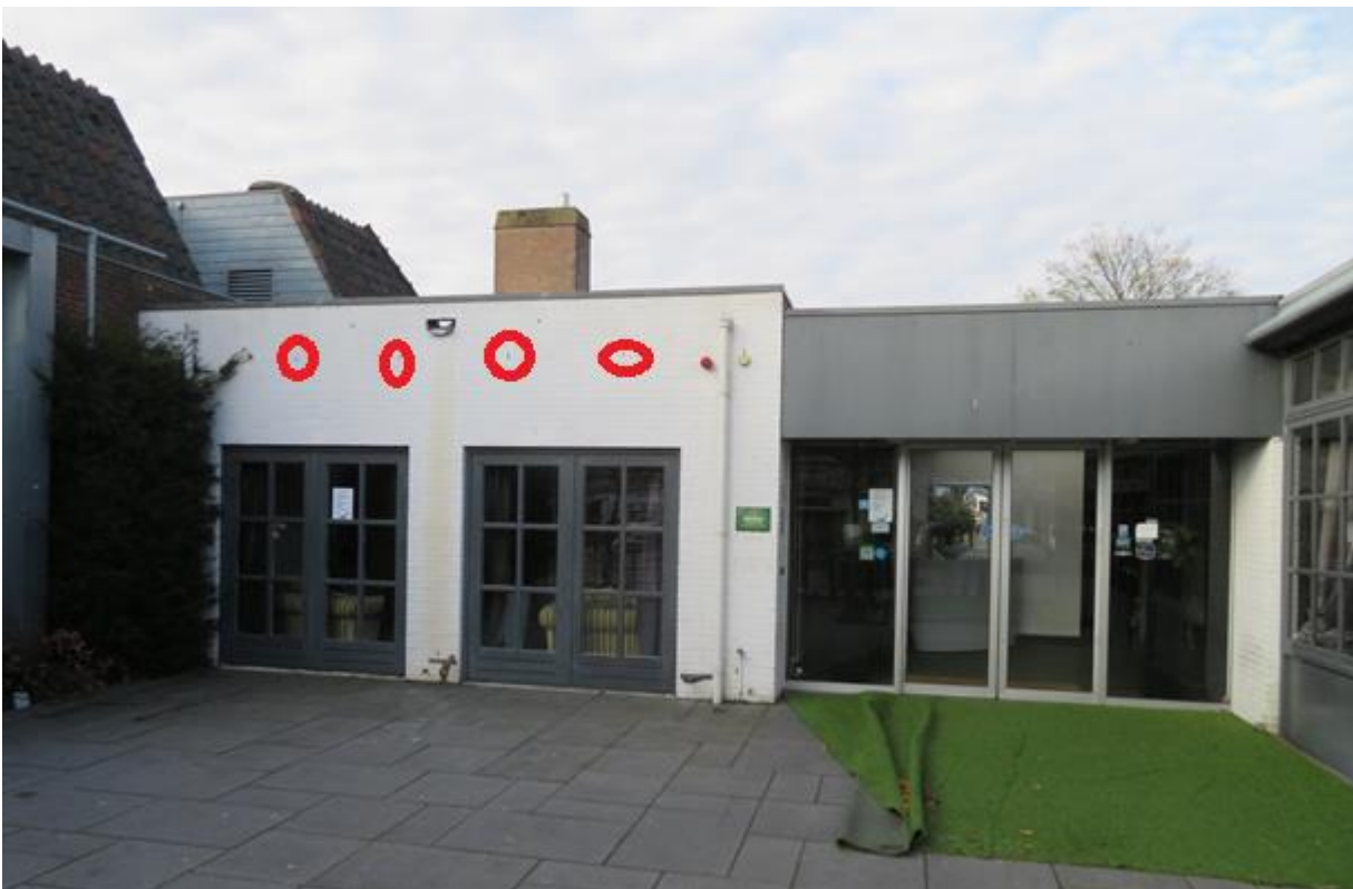
Fig. 6: Open stootvoegen in de laagbouw Haven 4.
