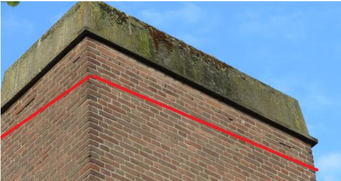
Fig. 5: Open stootvoegen aan alle kanten in de top van de schoorsteen van het ketelhuis. Ze zijn te klein voor grotere soorten vleermuizen, als laatvlieger.
