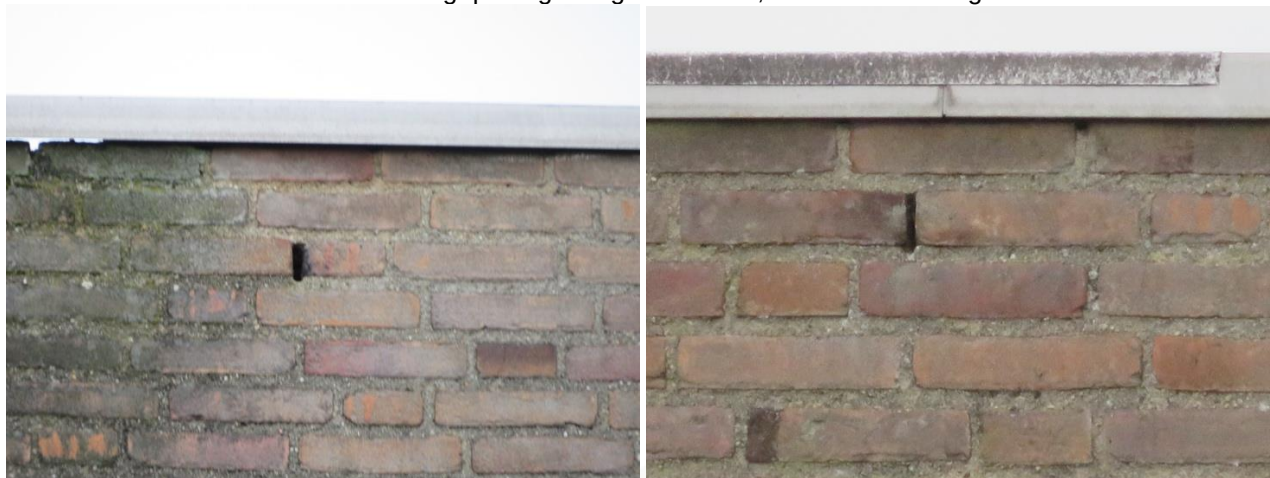
Afbeelding 6: Te kleine en smalle open stootvoegen net onder de dakrand.
