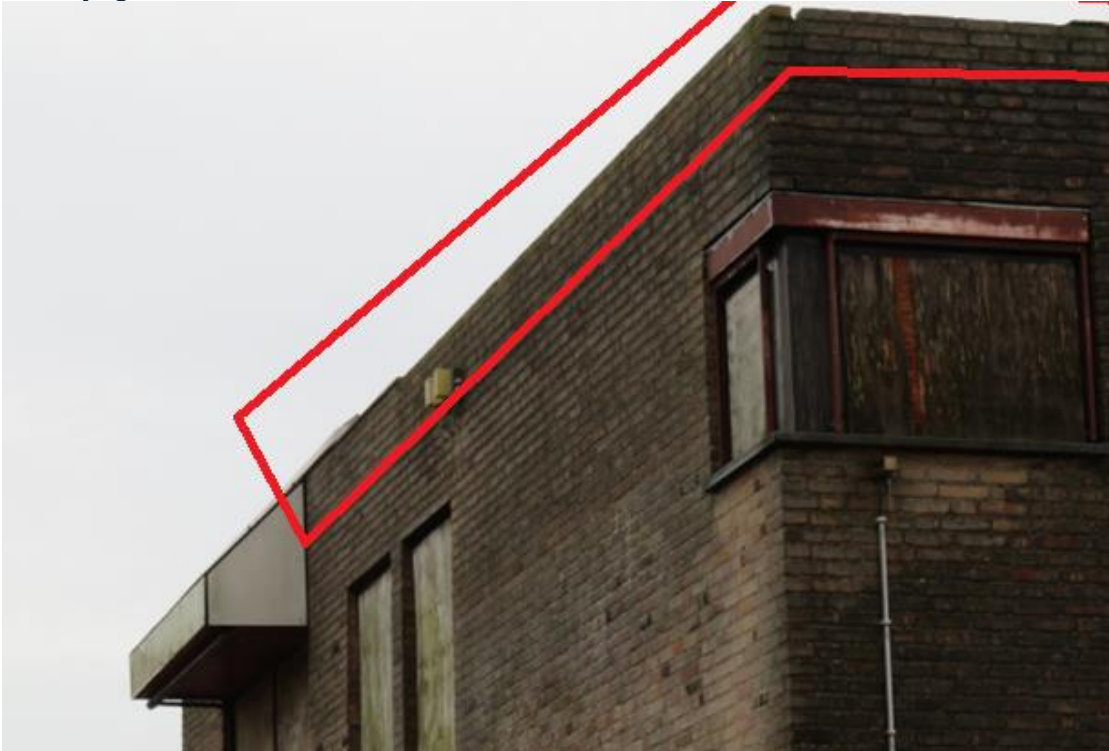
Foto waarop te zien is dat grote delen van de daklijst inclusief dakbedekking verdwenen zijn. Regenwater loopt hierdoor de spouw in.
