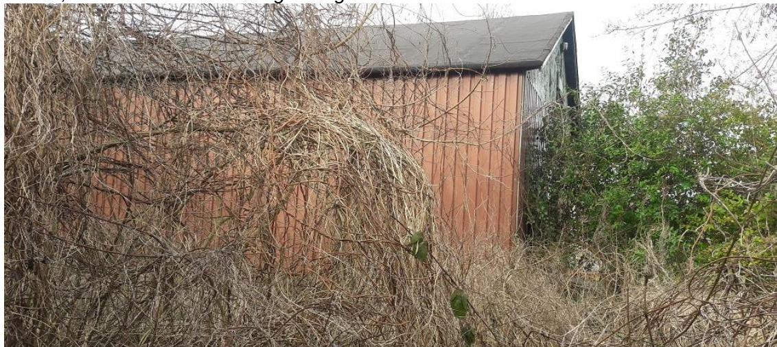
Foto 1, loods met vervuilde begroeiing
