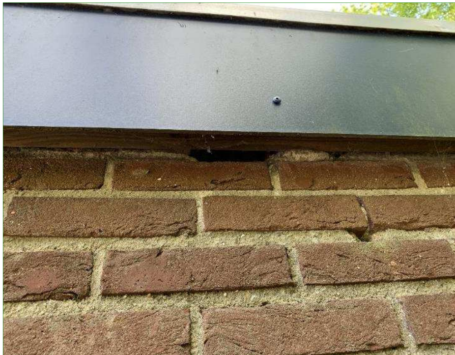
Gat onder daklijst.
