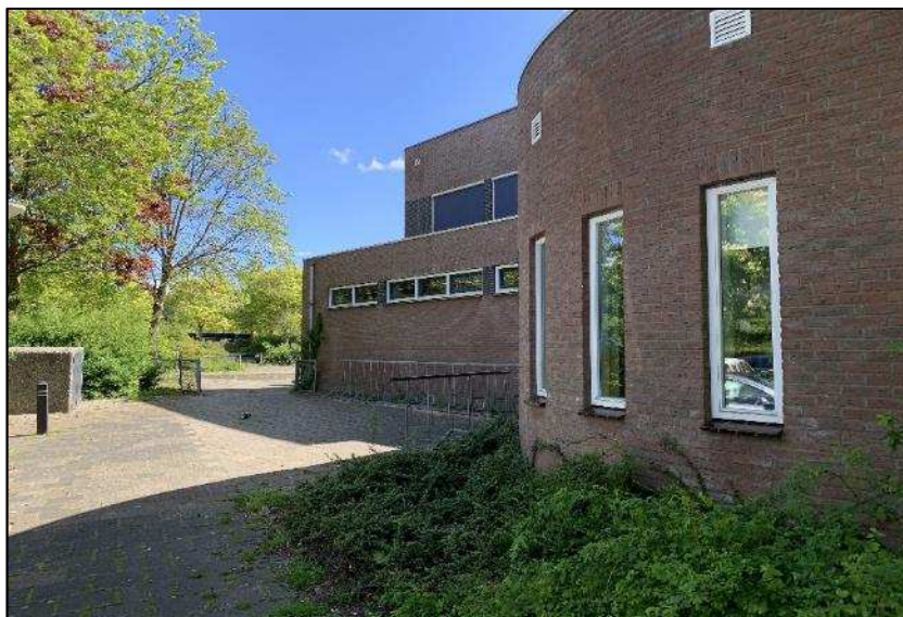
Open metselwerk met stootvoegen.
