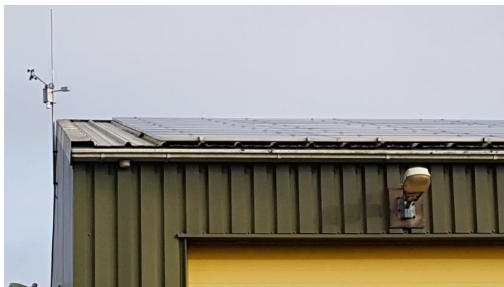
Dak van de loods met zonnepanelen (Foto's Laneco, 2020)
