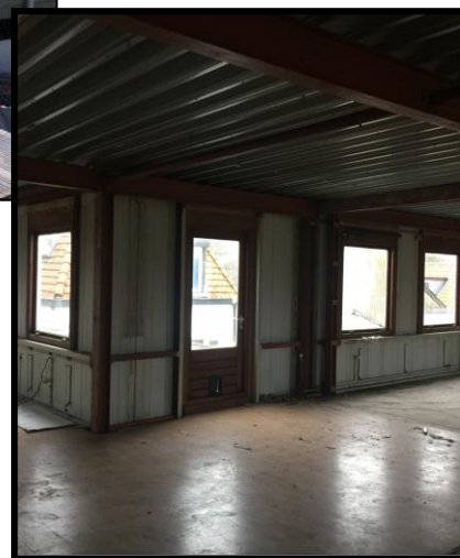
Afbeelding: de foto rechts geeft zicht op de binnenmuur van het gebouw. Duidelijk is dat er geen spouw aanwezig is.
