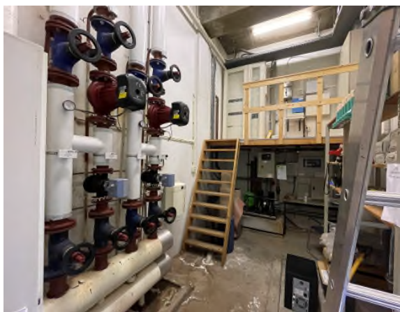
Technische ruimte schoolgebouw
