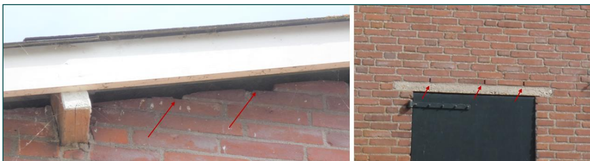
Figuur 3.1 De rode pijlen geven de openingen weer welke vleermuizen toegang bieden tot de spouwruimte en/of dakruimte.
