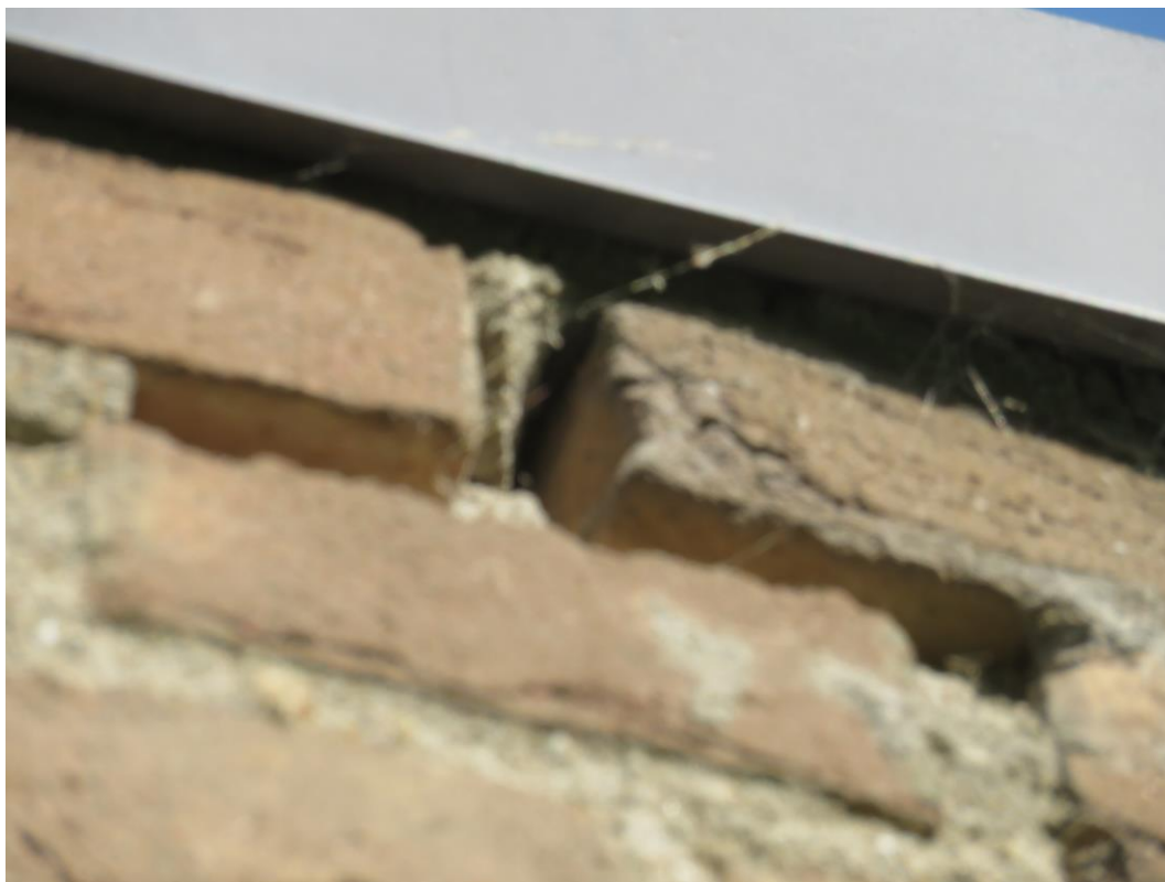
Spinrag voor een voor vleermuizen te kleine scheur in de gevel. Zoals te zien op de foto sluit de muur goed aan op de dakrand.
