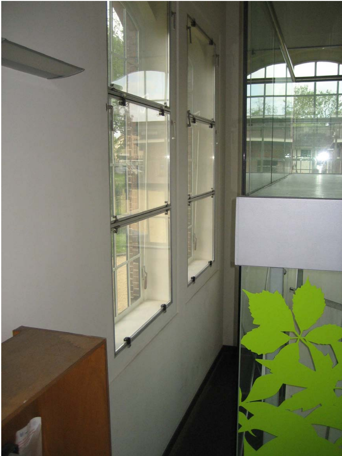
AFBEELDING 13 Te zien zijn de ramen die verlaagd zullen worden. Uitgaande van een zittende positie is het nu niet mogelijk fatsoenlijk naar buiten te kijken. Tevens is de 1 e verdiepingvloer te zien, welke los staat van de gevel. [foto GVB architecten 2012]
