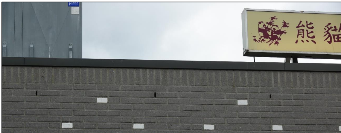
Figuur 30: Open stootvoegen in het noordelijk deel van het winkelcentrum welke door vleermuizen gebruikt kunnen worden.
