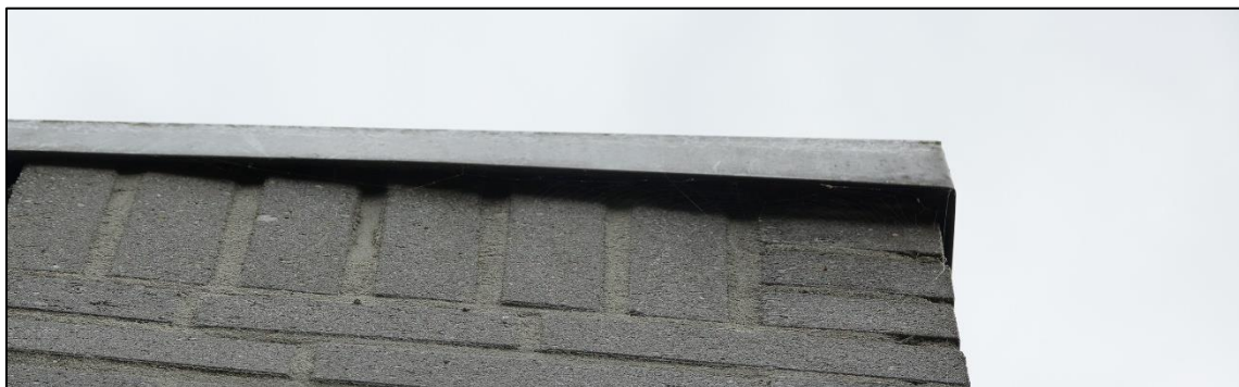
Figuur 31: Wijkende dakstrip waardoor vleermuizen toegang hebben tot een verblijfplaats.
