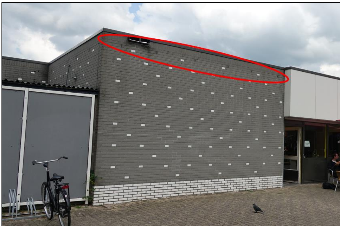
Figuur 21: Open stootvoegen in het centrale deel van het winkelcentrum naast de snackbar wat gesloopt zal worden.
