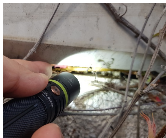
Dilatatievoeg, dichtgegroeid met stengels van de gevelbegroeiing
