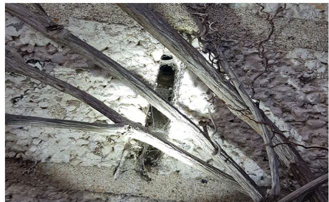
Smalle stootvoeg, gevuld met spinnenrag en geblokkeerd door gevelbegroeiing
