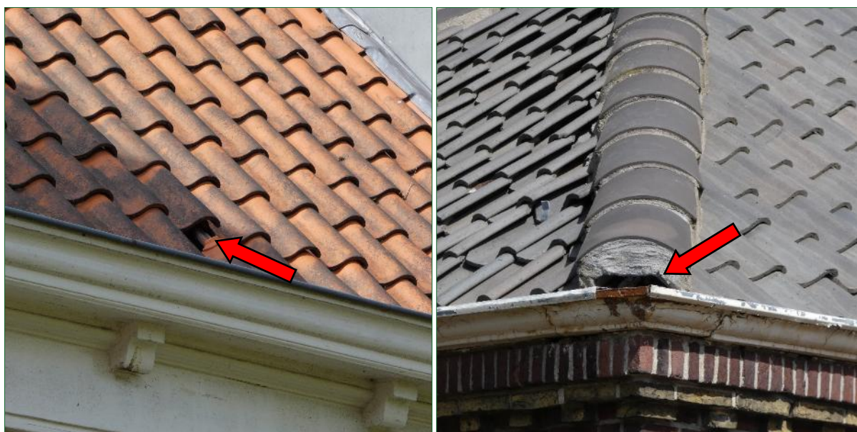
De openingen onder de dakpannen van de bebouwing geven mogelijk toegang tot voor Huismus geschikte achterliggende ruimtes.
