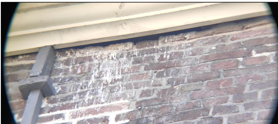
Figuur 12 opening tussen gevel en houtwerk met tekenen van bewoning
