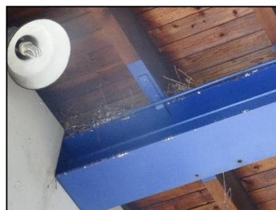
Figuur 8. Nesten onder de overkapping aan de zuidzijde van het autobedrijf.
