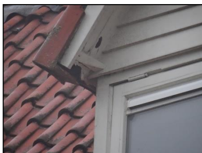
Figuur 17. Gat in dakkapel in een van woningen (nummer 1).
