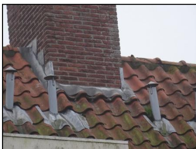
Figuur 35. Opening tussen loodslabben en dakpannen woningen (nummer 1).
