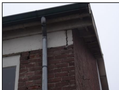
Figuur 36. Detailfoto van een scheur in buitenmuur van oude loods (nummer 2).
