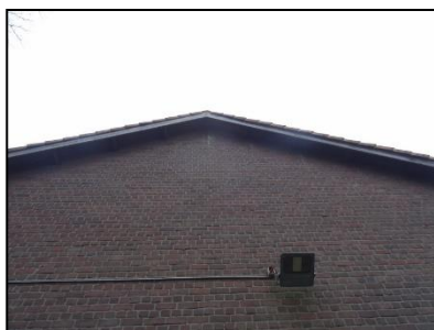
Figuur 20. Ruimte tussen gevel en kantpan en krijstrepen open loods (nummer 3).
