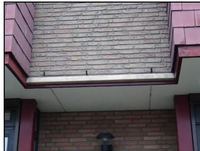
Figuur 39. Open stootvoegen in buitenmuur woningen (nummer 5).
