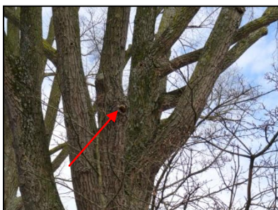
Figuur 14. Potentiële verblijfplaats voor vleermuizen
