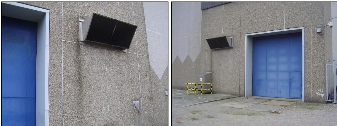
Afbeelding 5: Gevelrooster gasturbineomkasting [bron P11 + P12]
