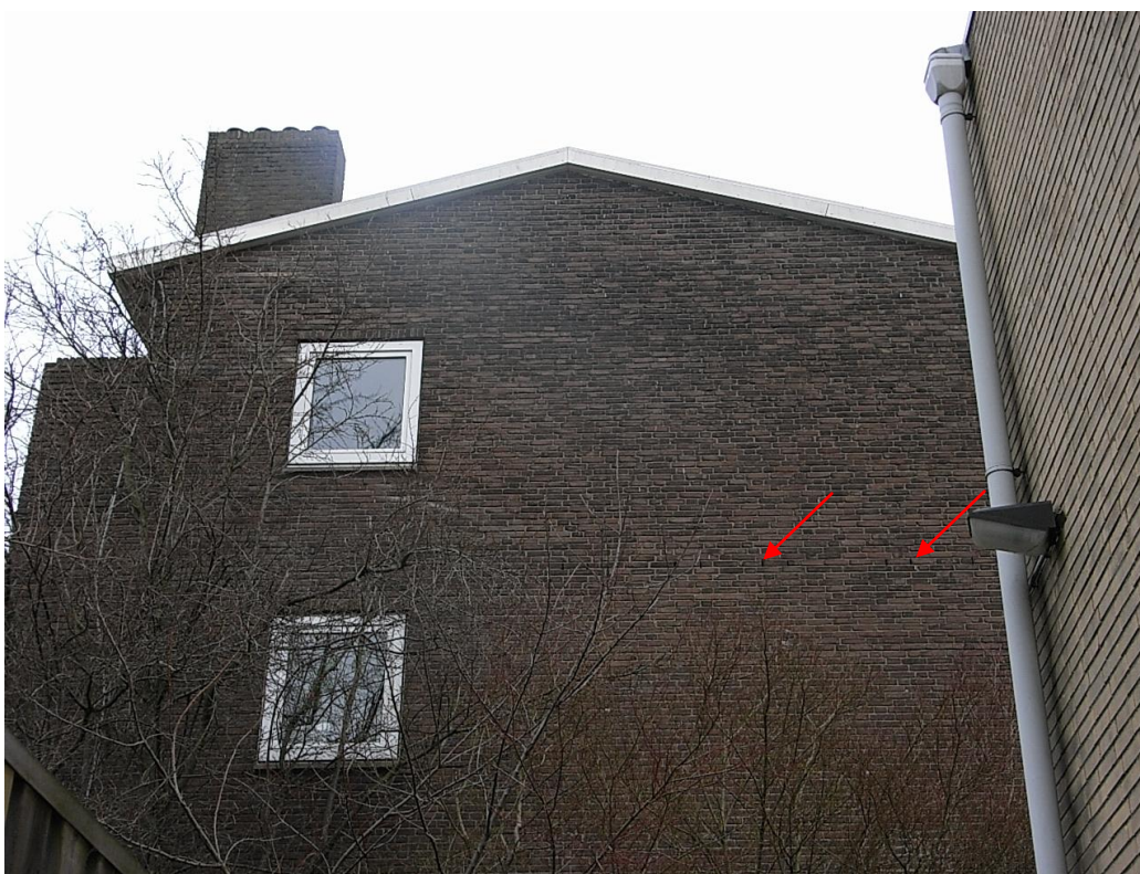
Foto 8: Laagbouw aan de Bernhardstraat. Door de aanwezigheid van open stootvoegen is de spouwmuur toegankelijk voor vleermuizen
