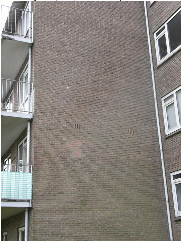
Foto 15: Open stootvoegen in het gebouw aan de Bernhardstaat
