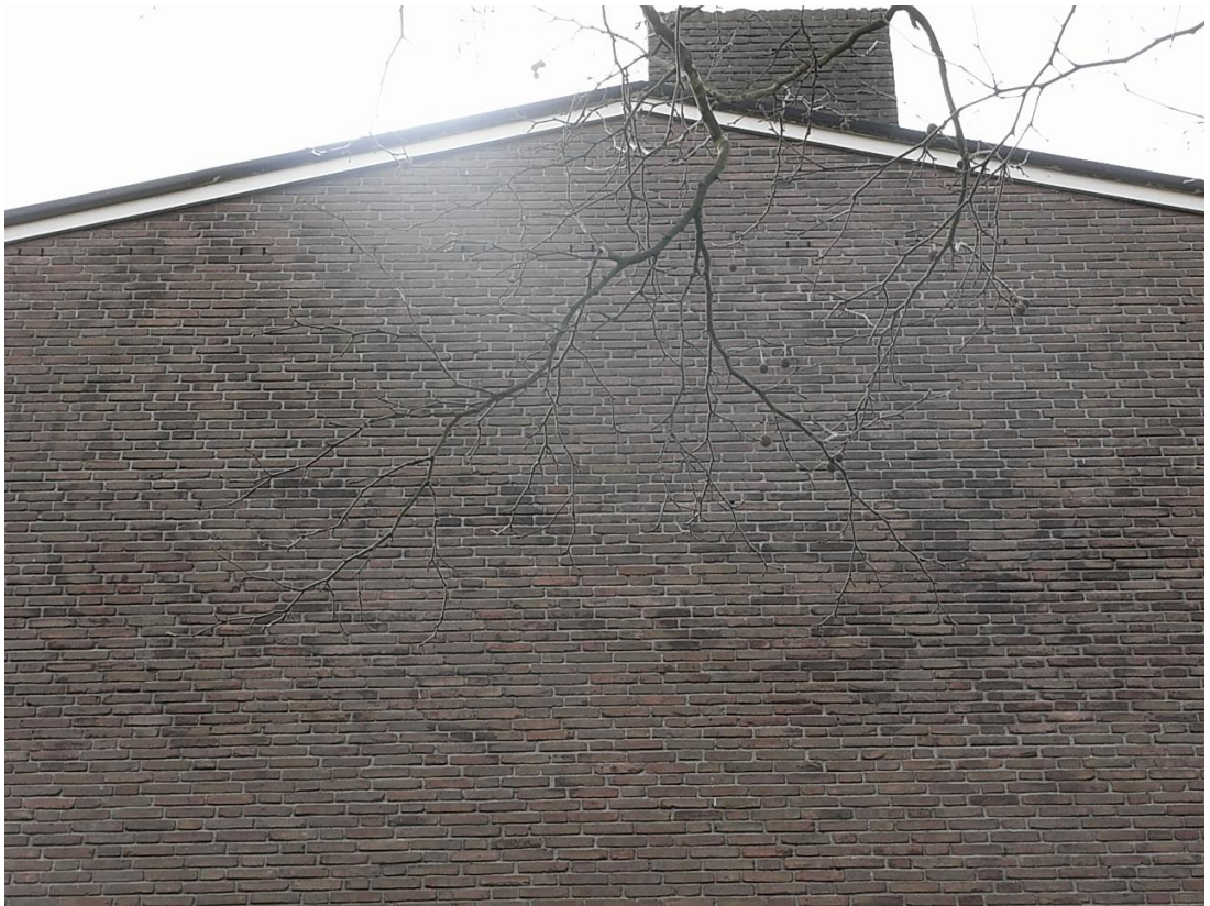
Foto 24: Open stootvoegen in de bebouwing aan J.P. Coenhof
