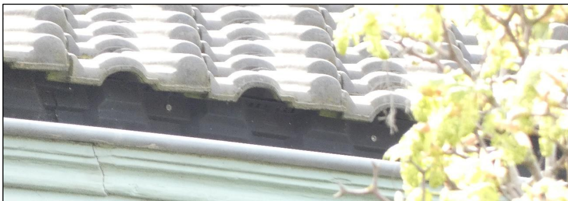
Figuur 20: Broedvogels en huismussen kunnen, vanwege een opstaande rand onder de eerste rij dakpannen, niet onder de dakpannen komen om te broeden.
