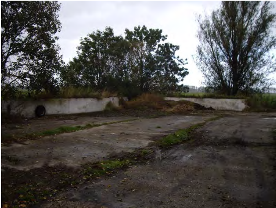
Locatie asfalt en olie verontreiniging
